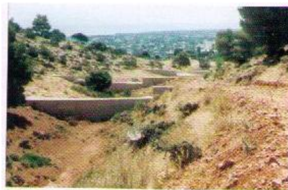
Σχήμα 13. Φράγματα από μπετόν στα όρια ορεινής και πεδινής λεκάνης για συγκράτηση φερτών (Πηγή: Μπαλούτσος 2010).
